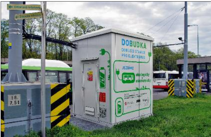
11. DC-DC-Wandler-Häuschen von Cegelec mit galvanischer Trennung; gespeist aus der Tramfahrlleitung liefert es 750 V DC für die Batteriebus-Ladung.
