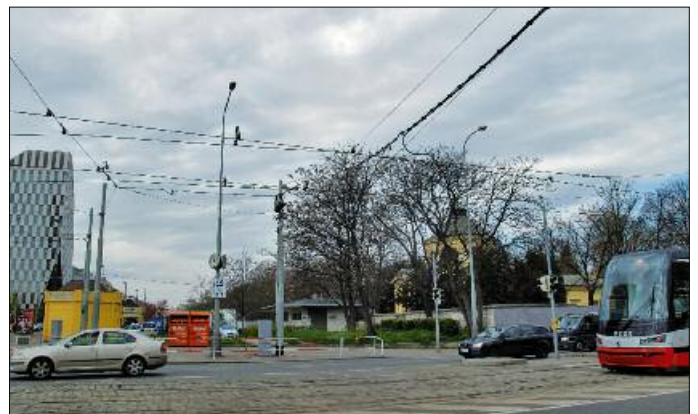
10. Verbindungen der Batteriebus-Ladestelle mit dem Fahrleitungsnetz der Straßenbahn und mit den Schienen über den hinteren Mast
